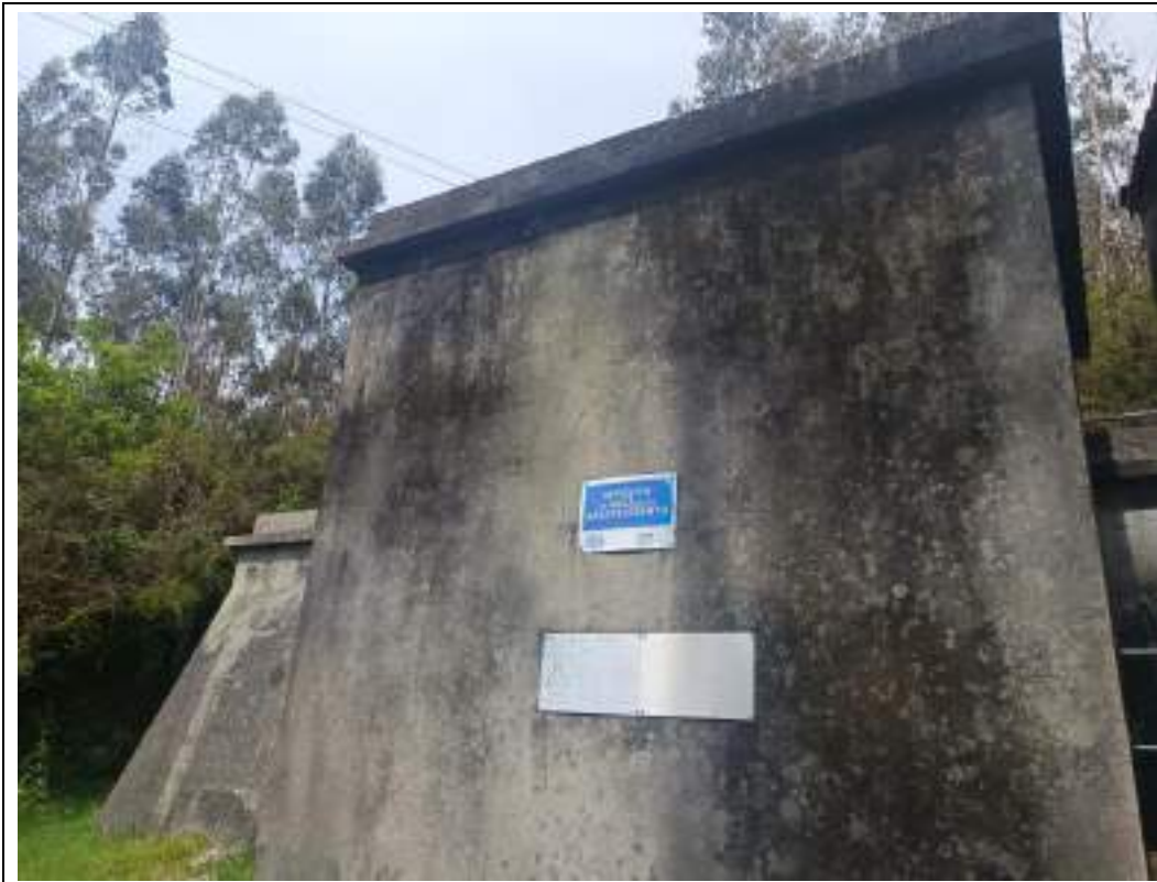
Foto 18. Exterior de cámara de claves de depósito anexo a ETAP
