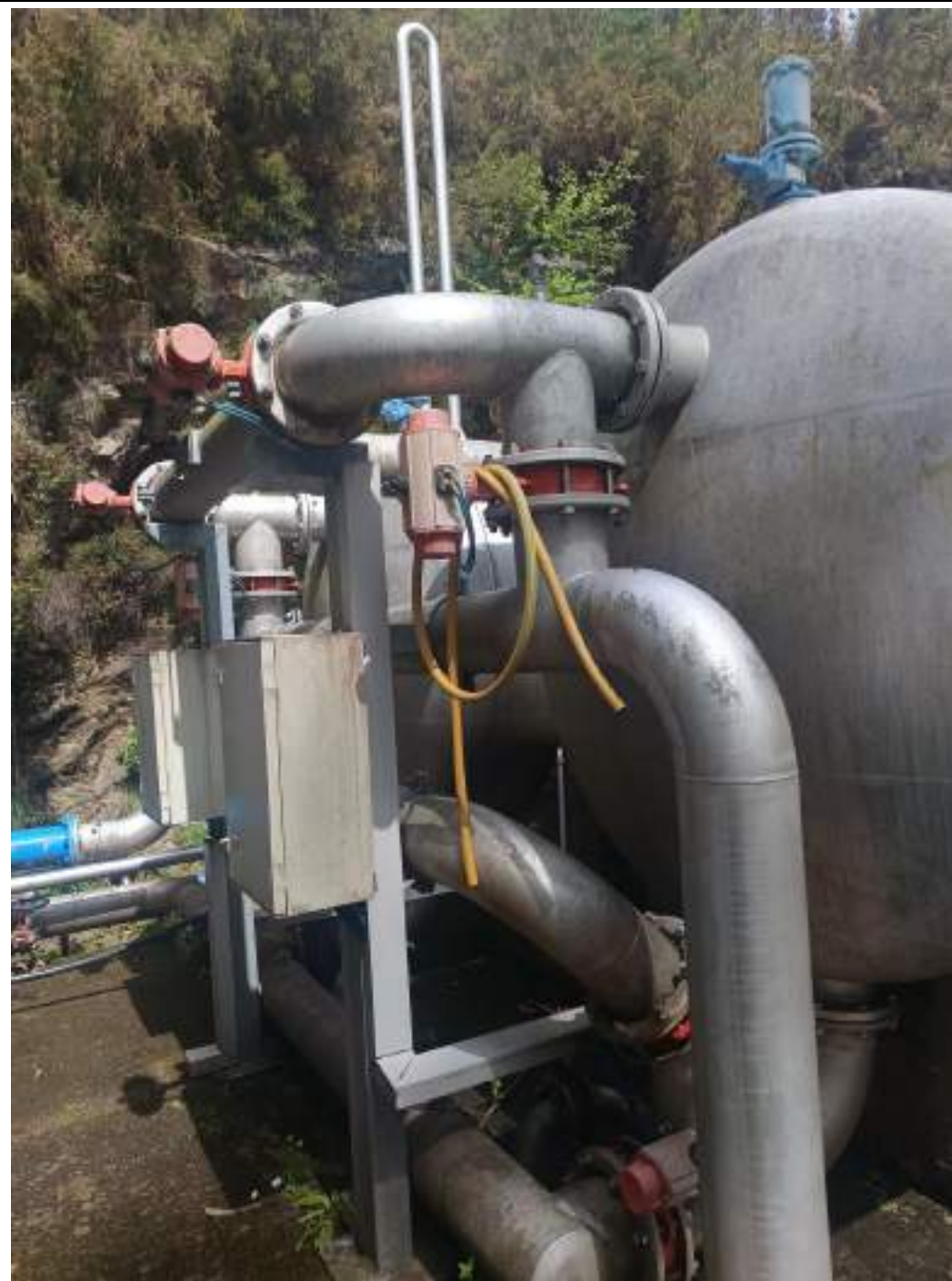
Foto 12. Válvulas neumáticas filtros pechados
