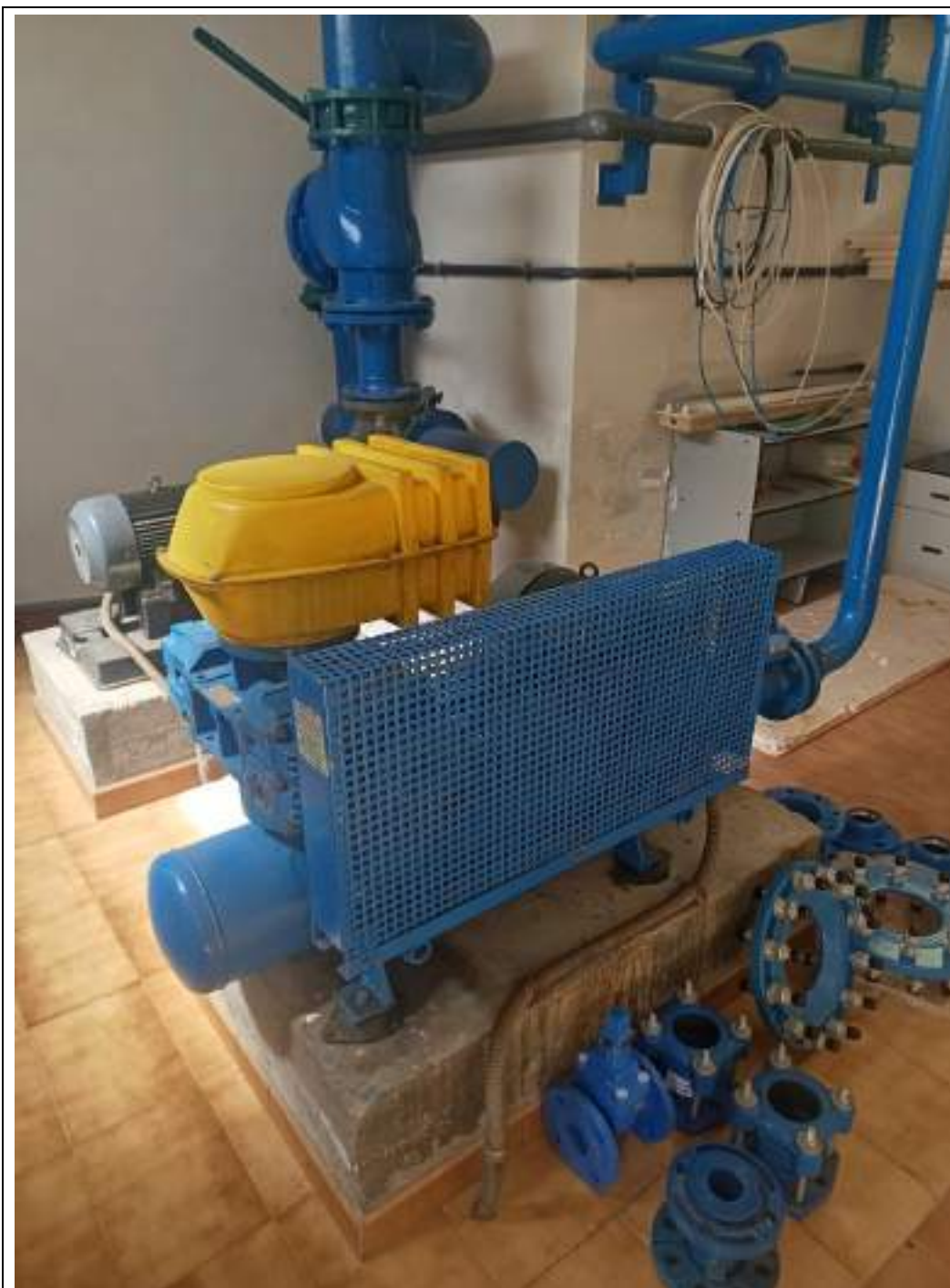
Foto 8. Soplante lavado filtros
