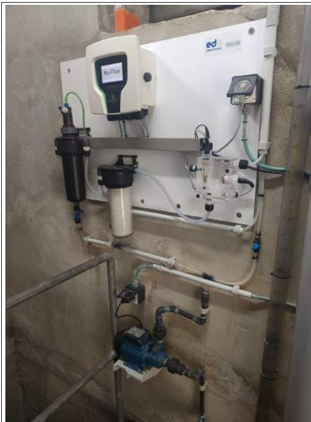
Foto 19. Dosificación de cloro no depósito anexo a ETAP
