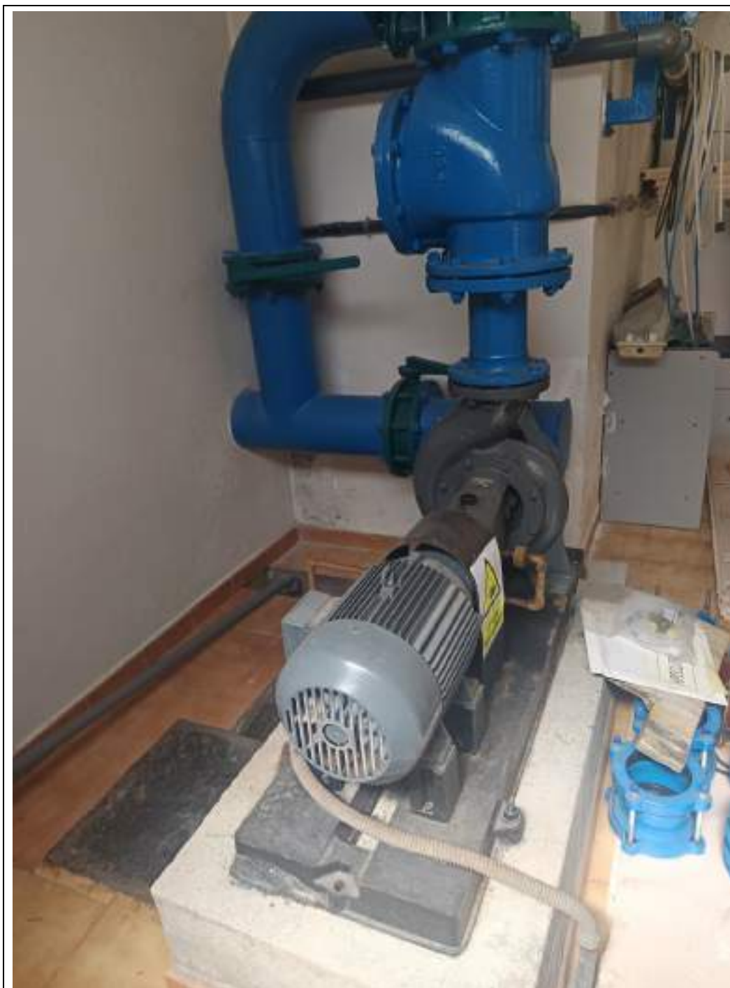
Foto 7. Bamba lavado de filtros
