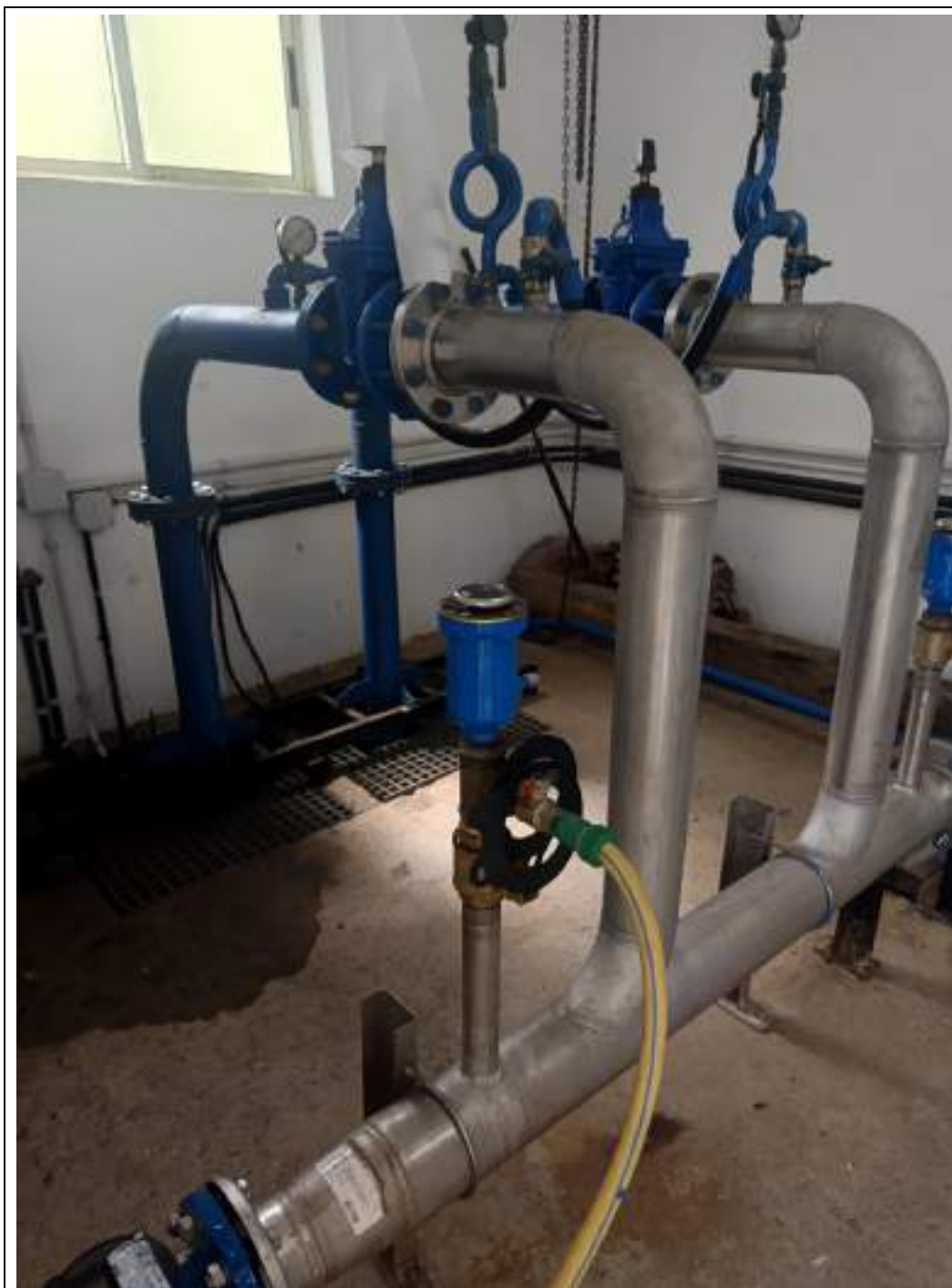
Foto 2. Bombas na captación e que impulsa a ETAP
