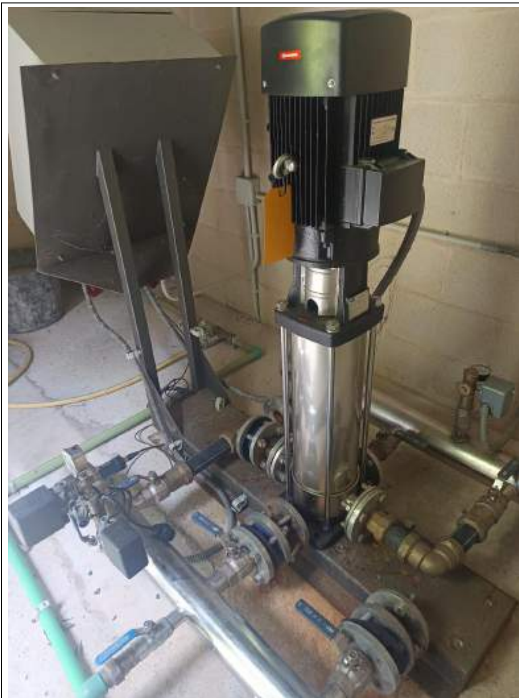
Foto 15. Bombas do grupo de presión (2 bombas en reparación)
