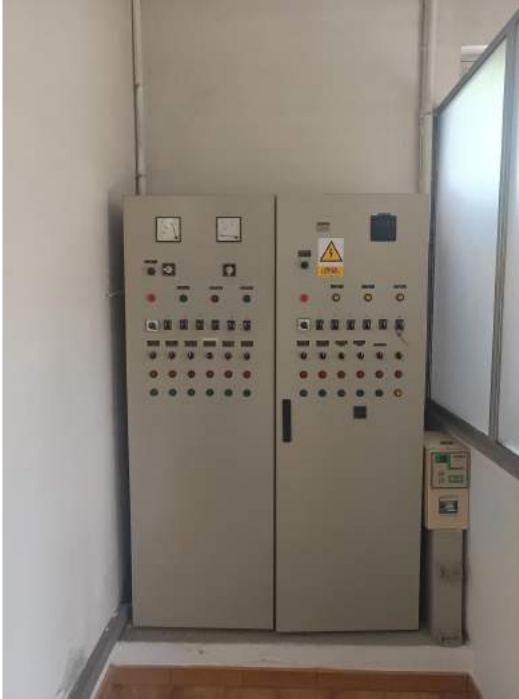
Foto 11. Cadro eléctrico ETAP
