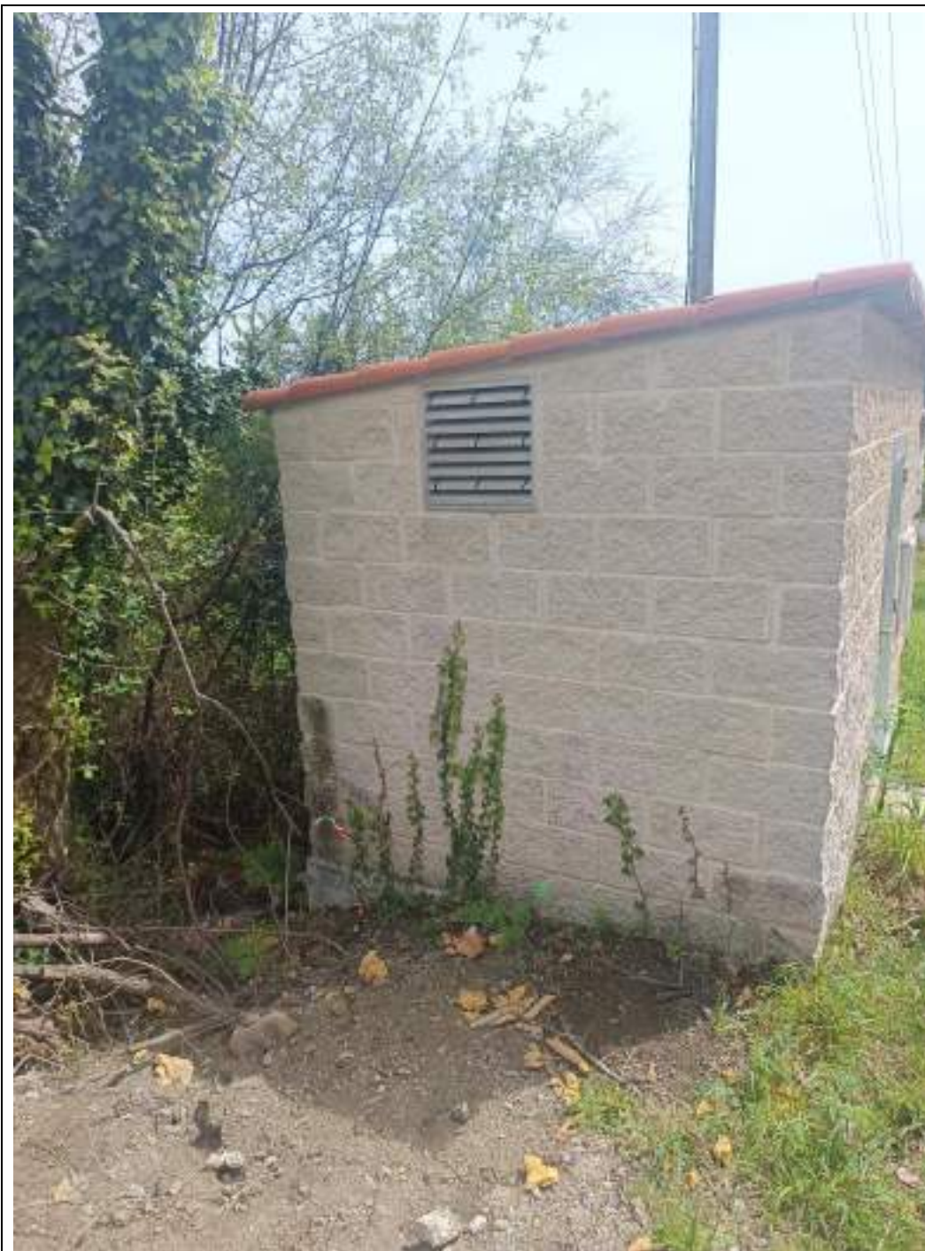
Foto 14. Caseta onde se atopa o grupo de presión
