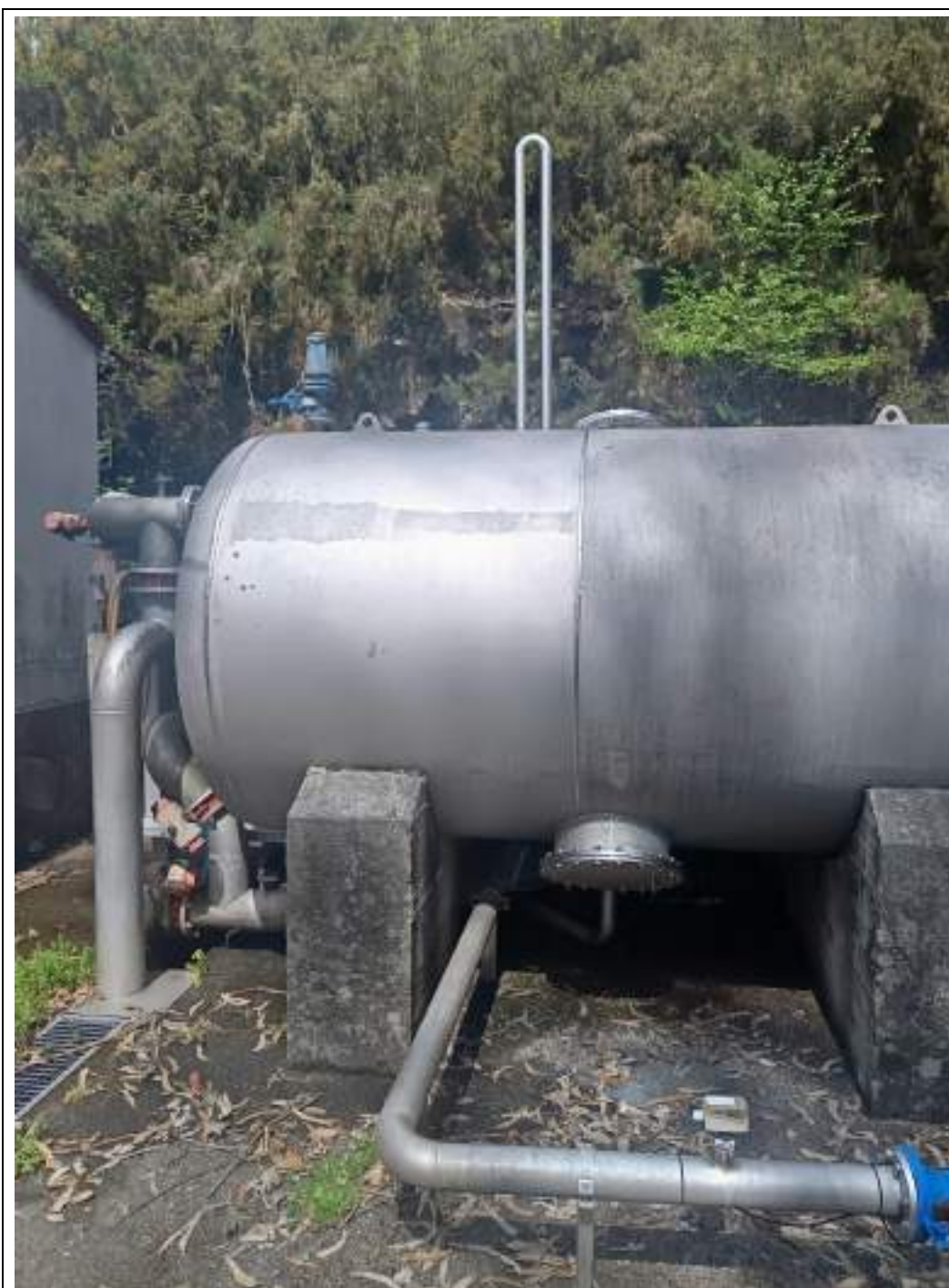
Foto 6. Filtros por área pechados, dotados de sistema automático de lavado e funcionamento
