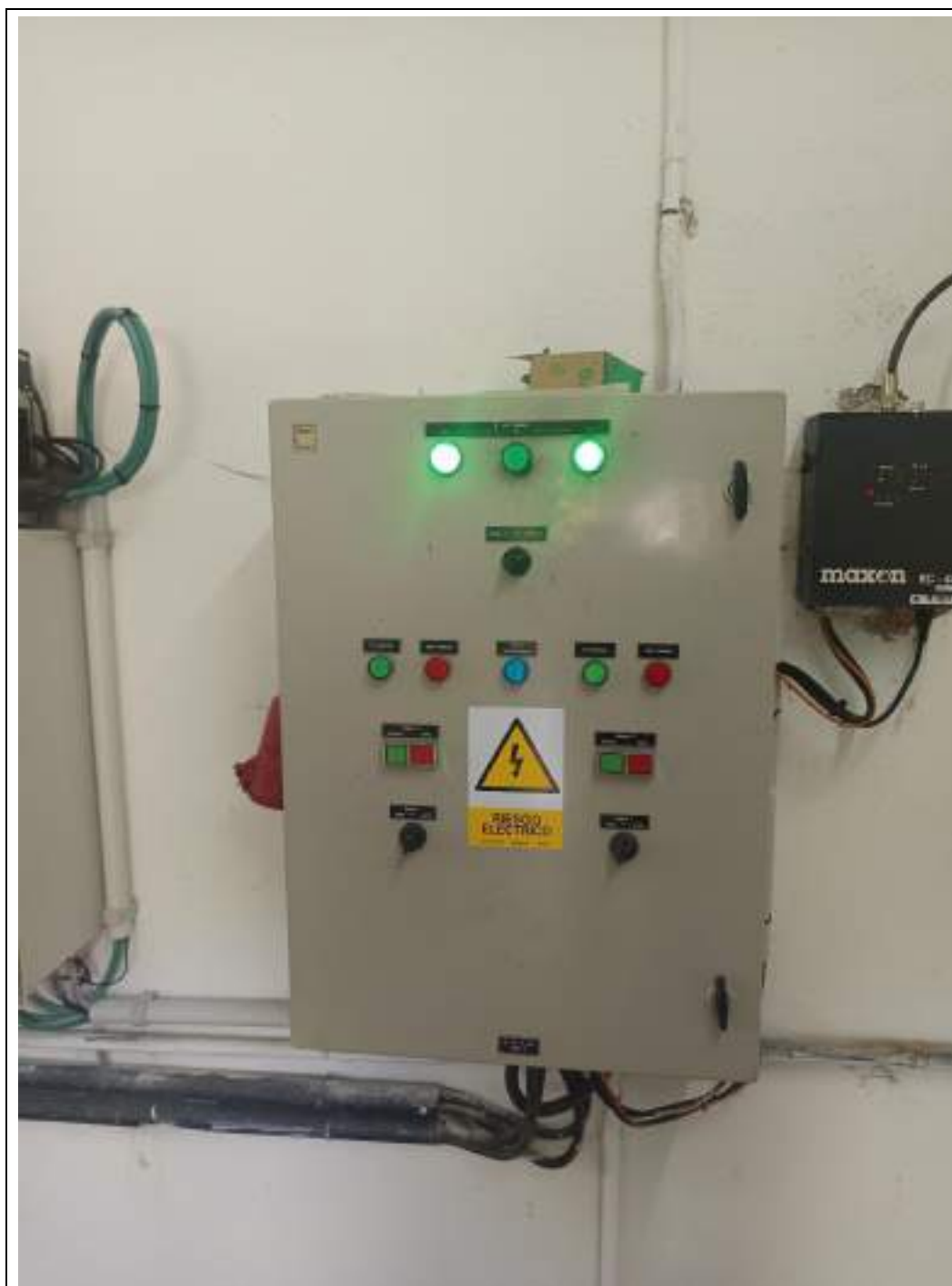
Foto 3. Cadro eléctrico do bombeo
